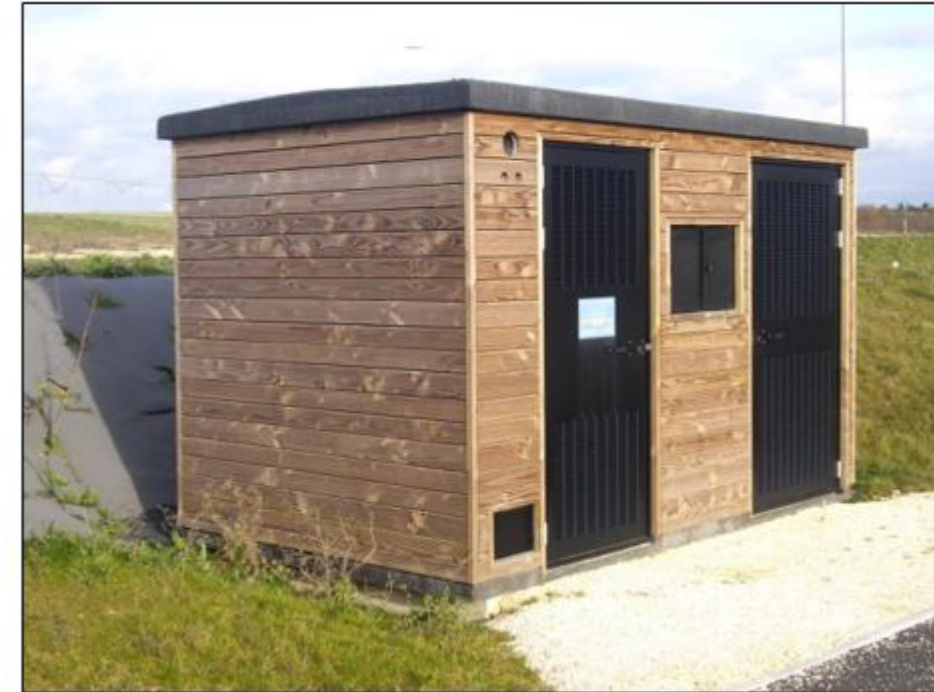
Illustration 21 : Exemple de poste de livraison
